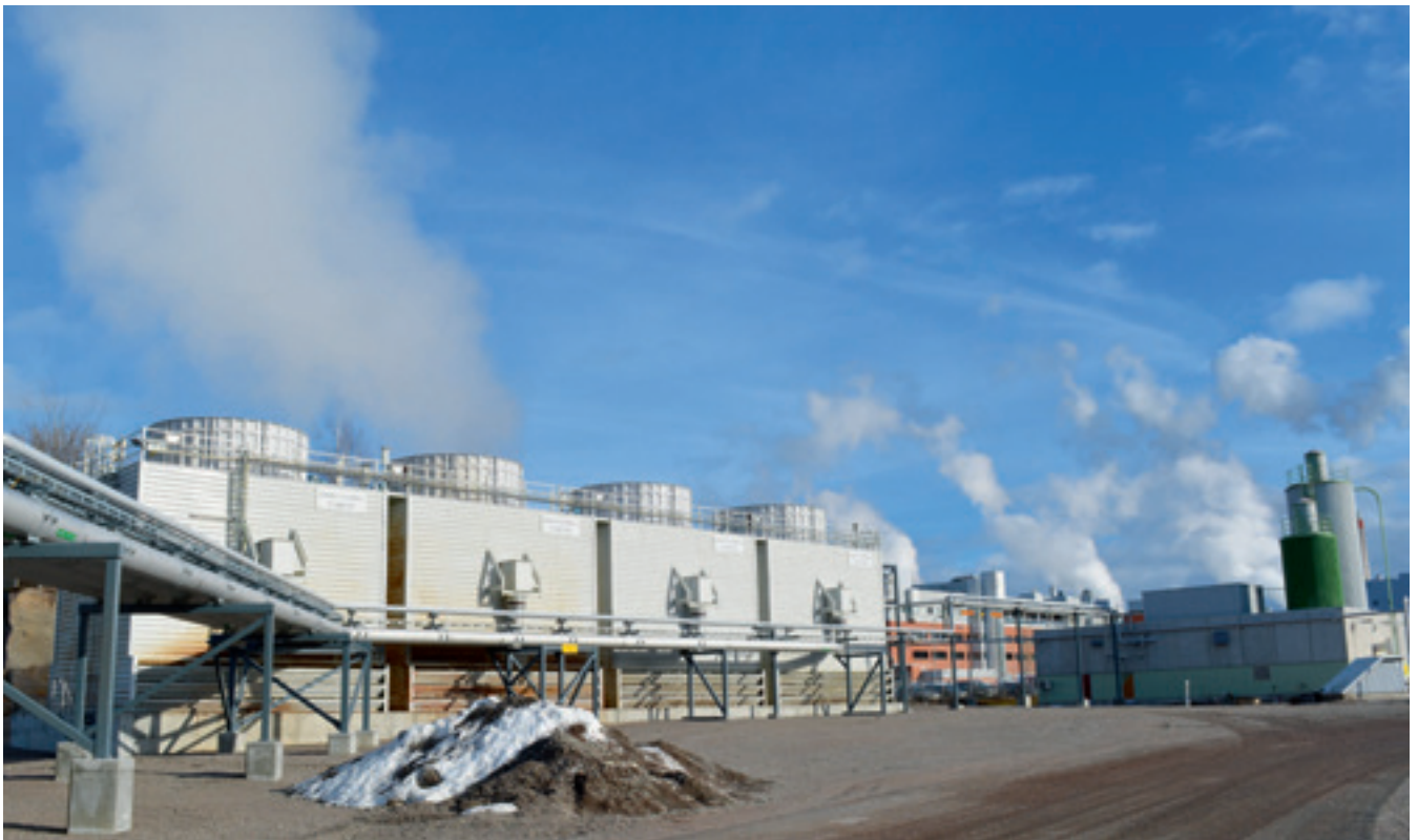
Kesällä 2016 otettiin käyttöön jäähdytystornit jätevedenpuhdistukseen johdettavan jäteveden jäähdytystehon ja koko jätevedenpuhdistamon käyttövarmuuden parantamiseksi.
