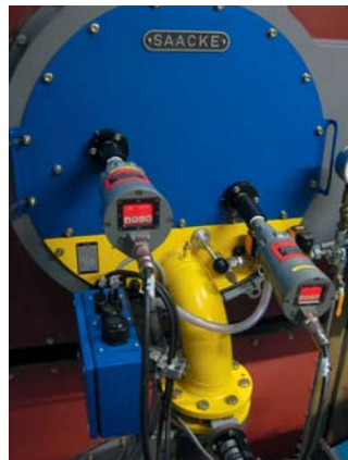
Neuer Gasbrenner Kessel 3
